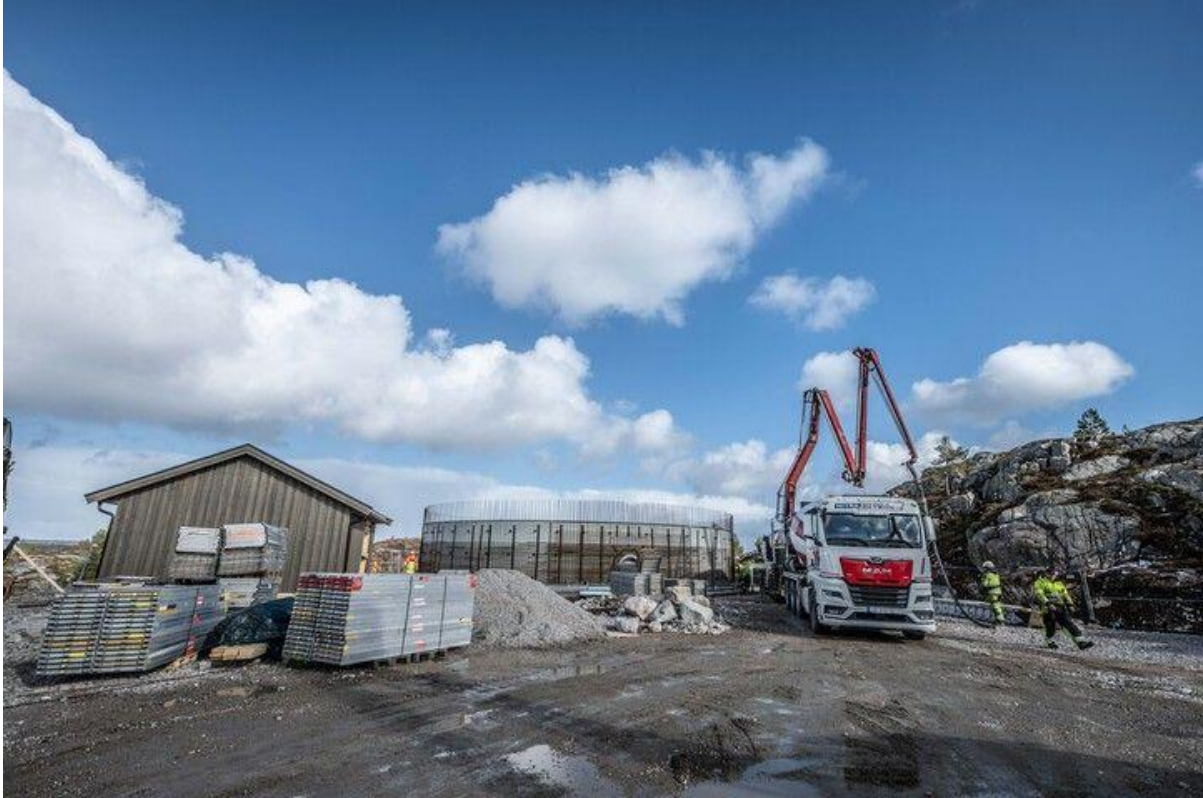
Bilde: Fra bygging av nytt høydebasseng på Litjsloka i Fillan. Foto: Marcin Szpryngiel, Hitra-Frøya Lokalavis.
