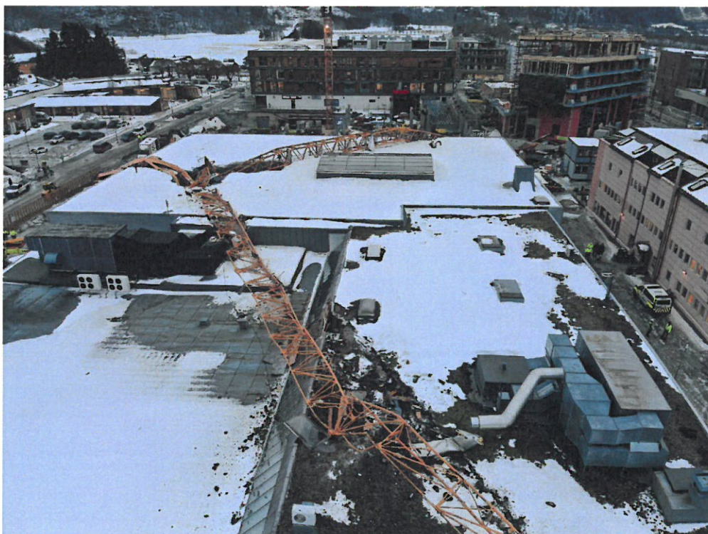
Heisekran falt på Melhustorget 6. januar 2023. Denne hendelsen fikk stor betydning både for lokalsamfunnet og oss. (Bilde tatt av brannvesenets drone).
