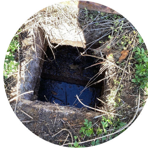
Plassbygd betongtank - sandfilter
