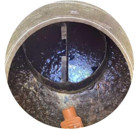
Slamavskiller sjø, tillatelse fra 2003 *usikker på utløpsledning
