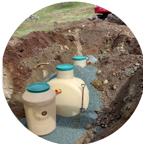
Slamavskiller og støtbelaster / pumpe
