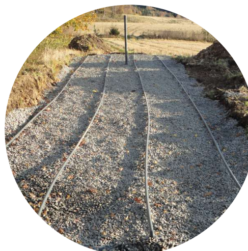
Infiltrasjonsflate med trykkrørfordeling
