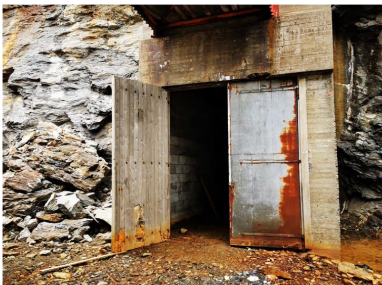
(Foto: DMF) Båndsjakt under råmalmsilo
