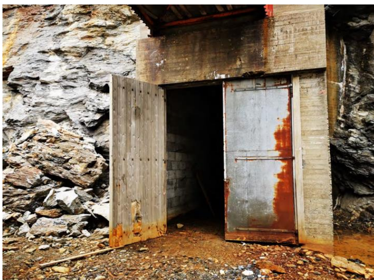
(Foto: DMF) Båndsjakt under råmalmsilo
