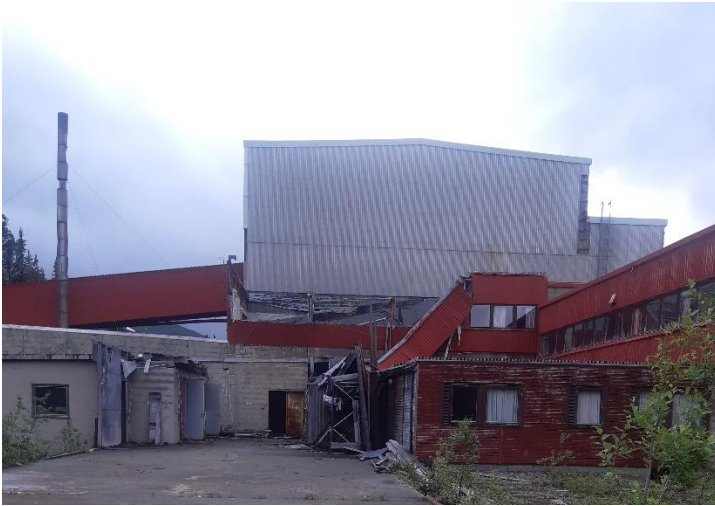
Baksiden av kontorbygg / skiftehus delvis sammenrast
