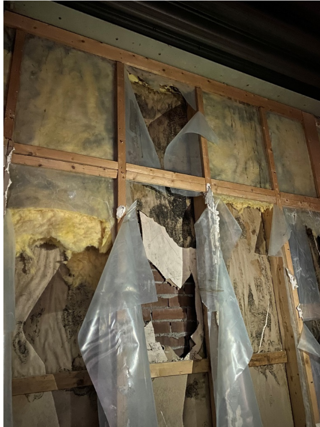
Figur 19. Bilde som viser fuktskader i teglsteinsvegg
