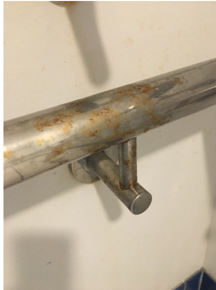
Figur 12. Bilde som viser rust på rekkverk
