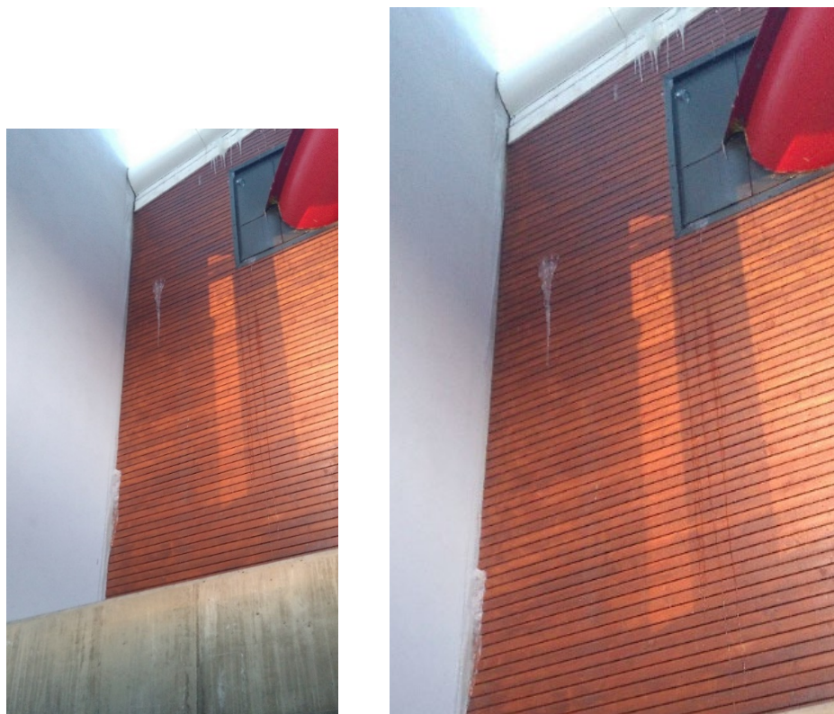
Figur 13. Bilde som viser isdannelser i sklietårnet
