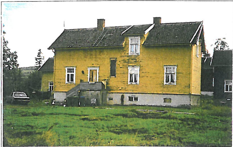
HUS nr. 2. Ombygget trapp. Malingsavskalling. Blendet trappevindu
